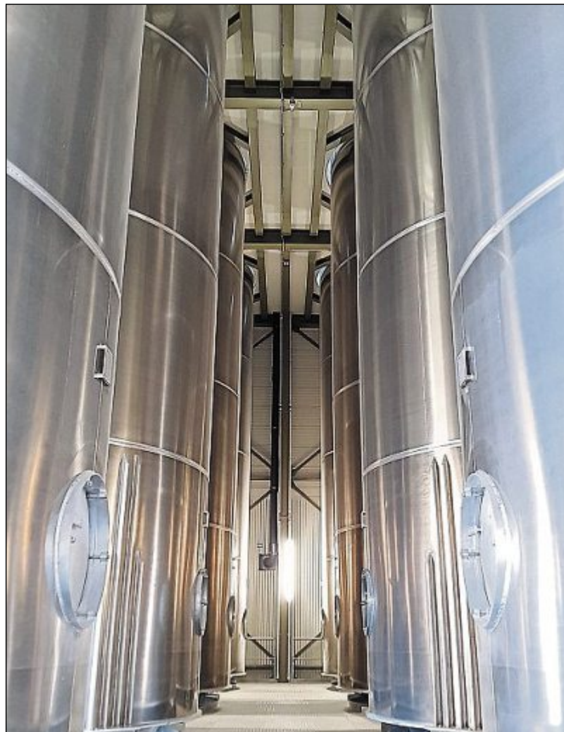
Ein Teil der zwölf Produktsilos.
